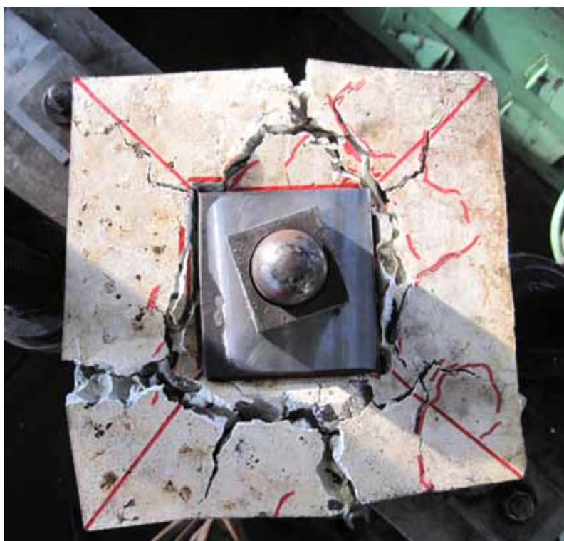
Экспериментальная база на станции Предпортовая была создана вскоре после образования НИИ мостов. Сегодня институт в рамках аттестованного Испытательного центра располагает уникальными возможностями проводить испытания материалов, узлов, деталей конструкций инженерных сооружений, вплоть до крупномасштабных фрагментов пролетных строений
