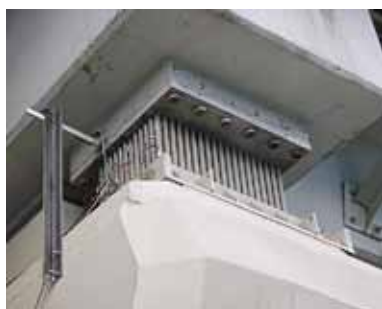
Измерительное оборудование, установленное на стержневом амортизаторе
