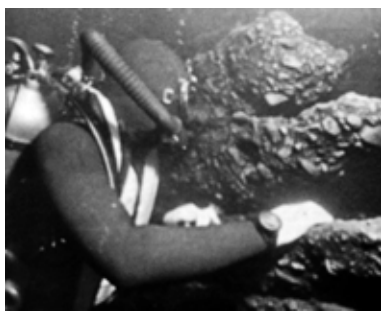
Обследование подводной части опор моста. Фото из архива водолазной группы НИИ мостов
