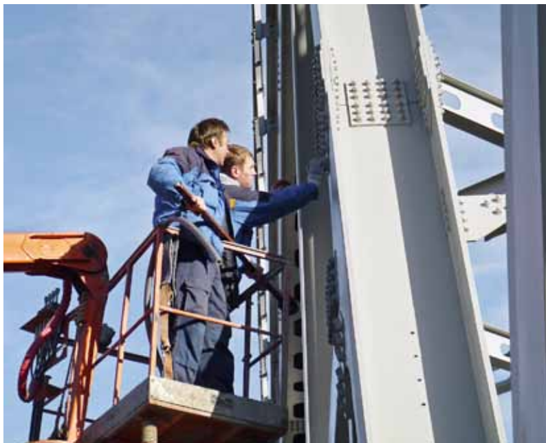
Измерение натяжения высокопрочных болтов пролетного строения моста на ПК 219 линии Адлер – Альпика-Сервис
