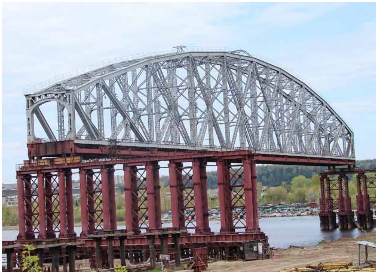
Демонтированное пролетное строение моста через реку Волгу в г. Зеленодольск проектировки Н. А. Белелюбского
